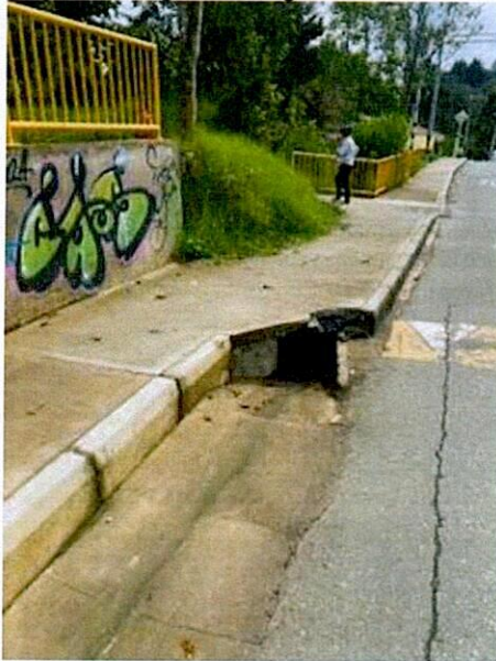
Daño andén Santa Elena
