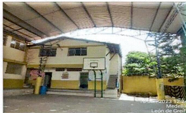
Ilustración 6 Estado inicial cancha - escalera de sala de profesores
