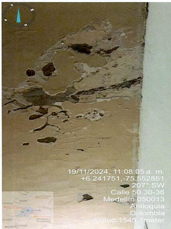
Humedades que reaparecieron en techos y paredes
