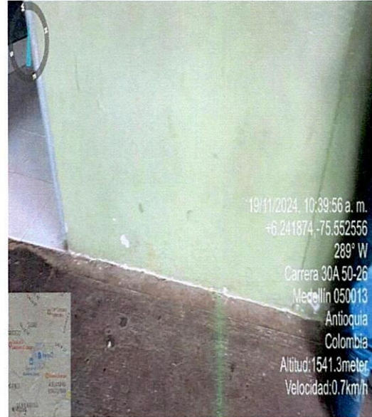
Paredes deterioradas por aplicar pintura no apta para exteriores y de mala calidad
