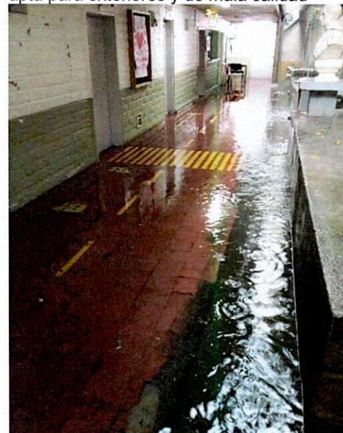
Inundaciones causadas por canoas y bajantes mal instalados
