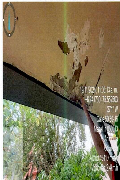
Canaos mal instaladas que están generando humedades en todo el perímetro de la Institución
