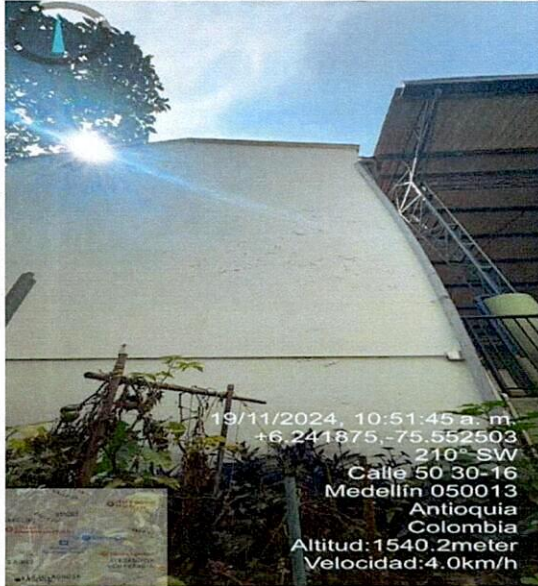
Paredes deterioradas por aplicar pintura no apta para exteriores y de mala calidad
